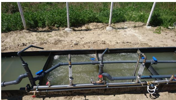
Figura 1. Instalația – pilot. De la dreapta la stânga compartiment anoxic, două compartimente aerobe, decantor lamelar.
